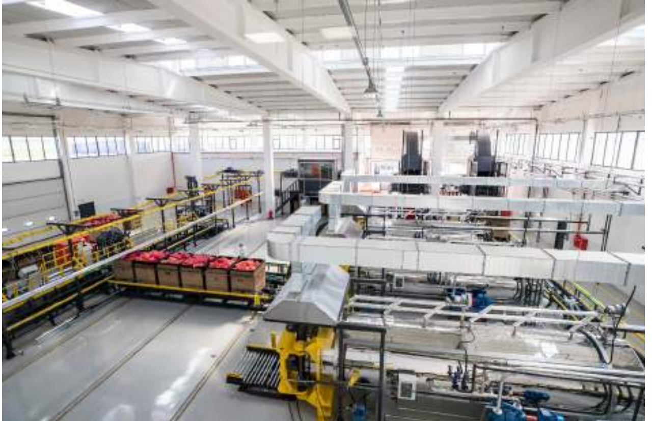
Tıbbi Atık Sterilizasyon Tesisi
